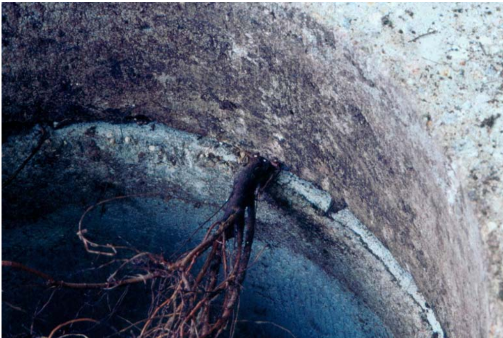
Abb.: Wurzeldurchdringung bei Bitumen-Dichtungsring zwischen Rohrabschnitten ( Ficus benjamina , Juni 2008)
