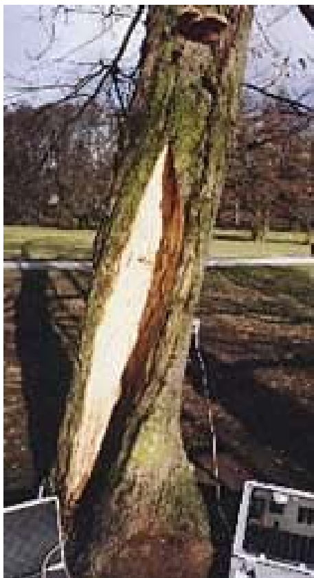
Abb. 8 Gefahr im Verzug! Vor Durchführung des Sägeschnittes waren zwei eindeutige Defektsymptome, erkennbar: 1. Abgestorbene und tief eingesunkene Rindenpartien als Folge einer nach außen durchgebrochenen ausge dehnten Fäule und 2. Ausbildung von Pilzfrucht-körpern an der Schadstelle. Zudem stand der Baum geneigt und erforderte daher besonderes Augenmerk. Foto: Thomas Sinn
